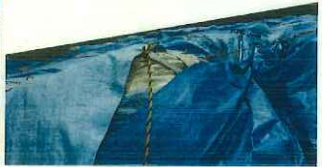
シートを追加被覆したものの雨水の重みでシートがズレ、フレックシブルシートが剥きだしになっている。
