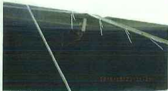
ハウス軒桁中央部たわみ状況 (破損しているのは軒先金物)
