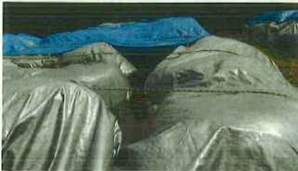
シート面が凸凹となったため、水や落ち葉がたまっている。
