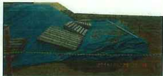
屋外ブロック端部現況
