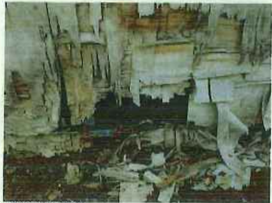
ハウス厩壁破損状況
