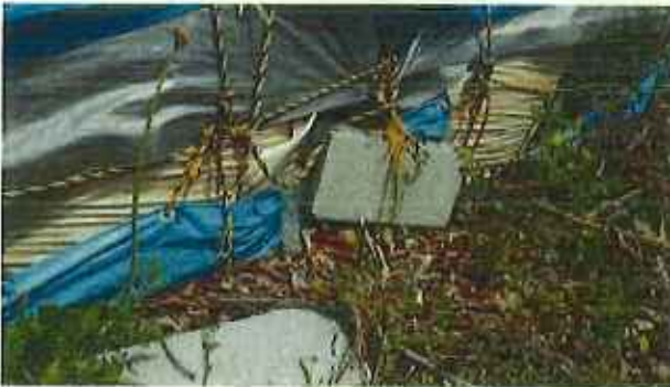
シートを追加被覆したものの雨水の重みでシートが引き上げられ、フレックシブルシートが剥きだしに
