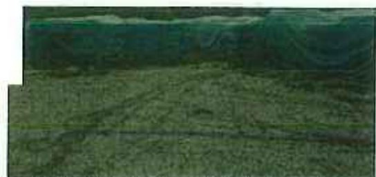
シートは全面を覆われており、飛散流出のおそれはないが、点検は必要。
