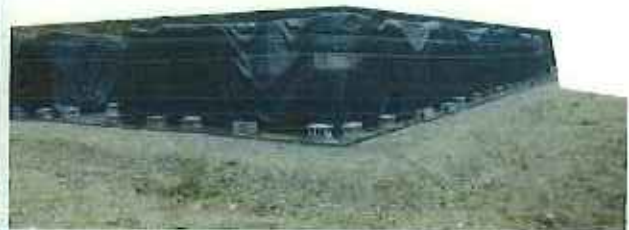
フレコン2段積み 二段目はロープで押さえ 遮水シート底部はコンクリートブロックで押さえ
