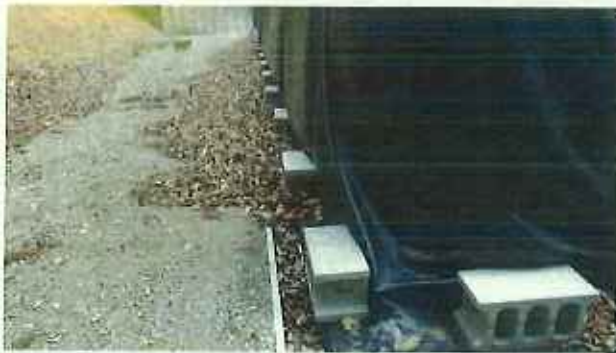
落ち葉が側溝からはみ出ている。
