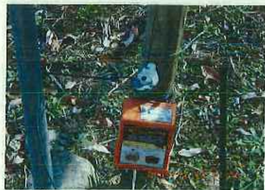
周囲に通電設備あり。
