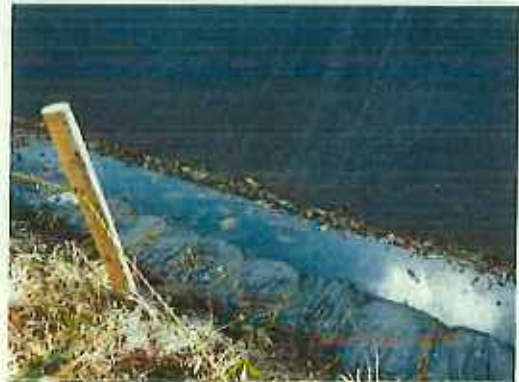
保管場所（囲い）ロープが1箇所切れ有り。土のう袋と遮水シート間に水たまりが見られる。
