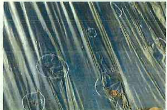
六・破れ等破損部分
