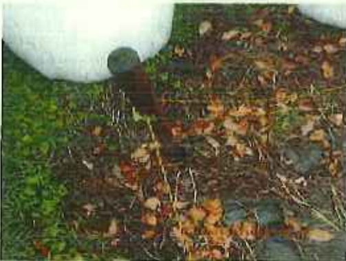
杭が少し傾いている
