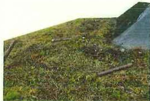
困い(杭が腐って倒れている)
