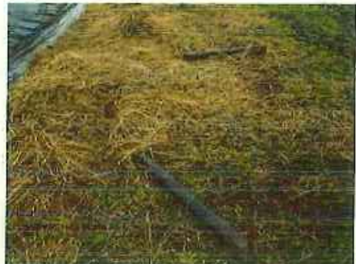
囲い(杭が腐って倒れている)
