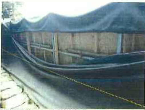
型枠用合板外側(シート接着剥がれ)
