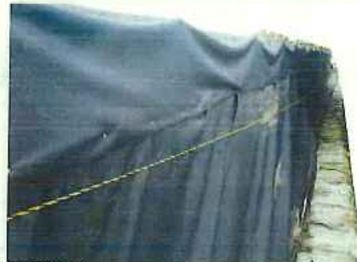
型枠用合板外側(シート接着剥がれ)
