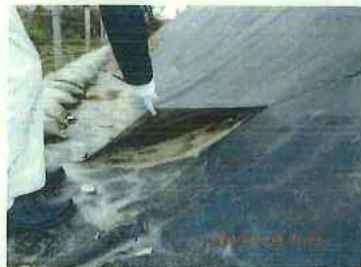
遮水シートのはがれ(接着不良)が数カ所ある
