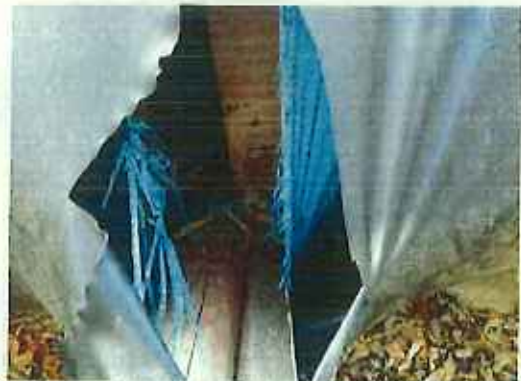
4側面のコンパネがはらみ杭が倒れてシートが破損。
