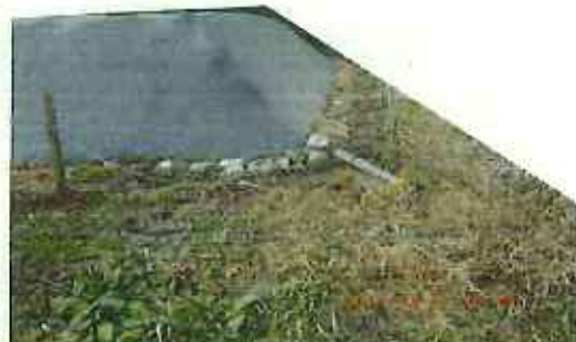
北西側の杭が(腐食で)倒れている。
