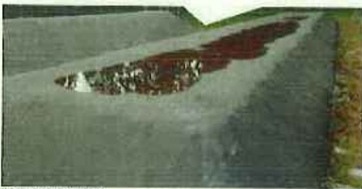
保管場所上部(堆肥) 水たまりがある
