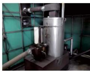
【バイオマス(もみ殻)ボイラー】
