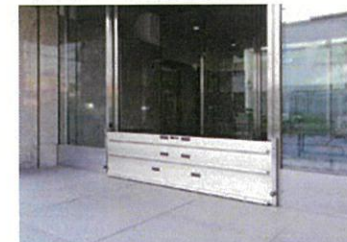
浸水対策④ 防水パネル設置例
